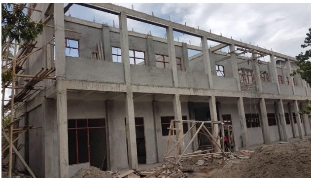
Der Bau des zweiten Teils unserer Mittelschule SMP Anda Luri in Waingapu
